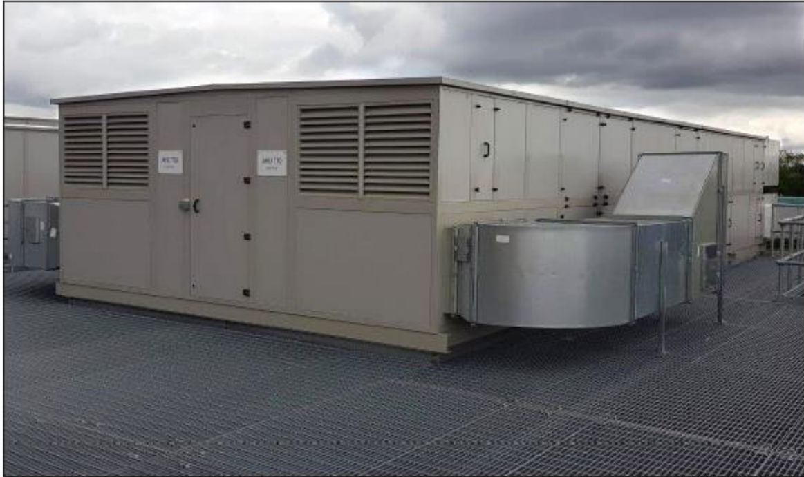
Bagian Luar Air Handling Unit tipe Planroom
