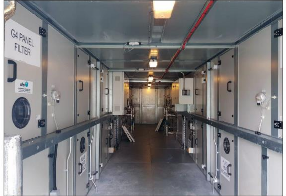
Bagian Dalam Tipe Air Handling Unit PlantRoom
